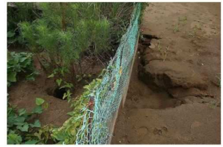
写真 敷地境界に跨る噴砂孔と、懸垂しているブロック塀(撮影地点⑰)
