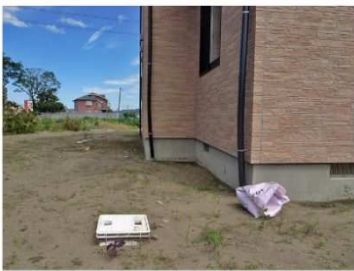
写真 液状化による住宅基礎の沈下
