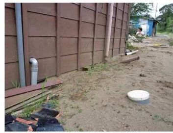
写真 液状化による布基礎の沈下
