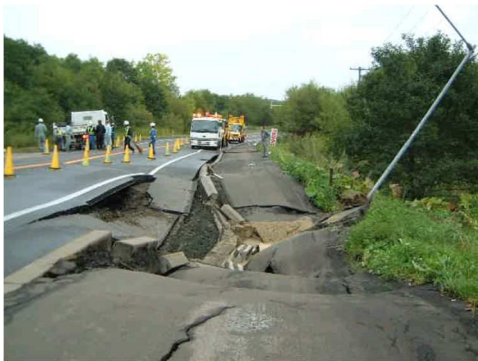
湿地側路面の変状と法面の崩壊
