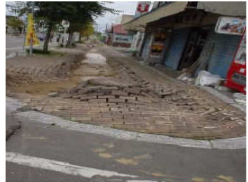
豊頃駅前の液状化による歩道の全面的破壊
