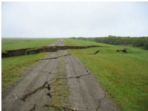
十勝川 亀裂・段差状況 ウツナイ築堤
