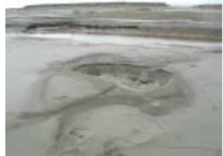
釧路港西港区第 4 埠頭 噴砂発生状況
