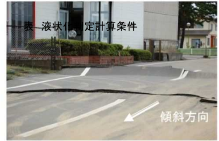
写真 地盤の傾斜方向への舗装の流れ (本震4時間後)(撮影地点⑨)
