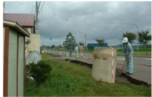
音別町 マンホール浮上り状況
