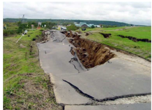
十勝川 盛土崩壊状況 大津築堤
