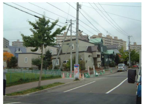
液状化による住宅の傾斜状況
