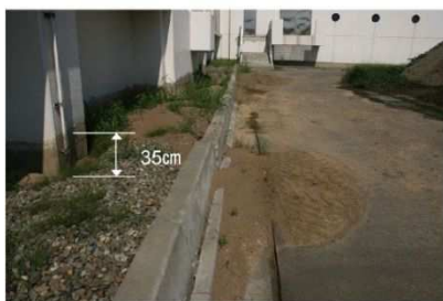
写真 処理施設東側の噴砂と地盤沈下
